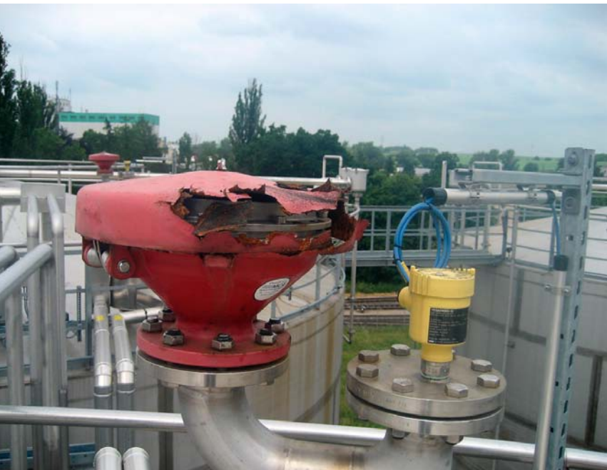
Bild 1: Schutzsystem in minderwertiger Materialausführung
