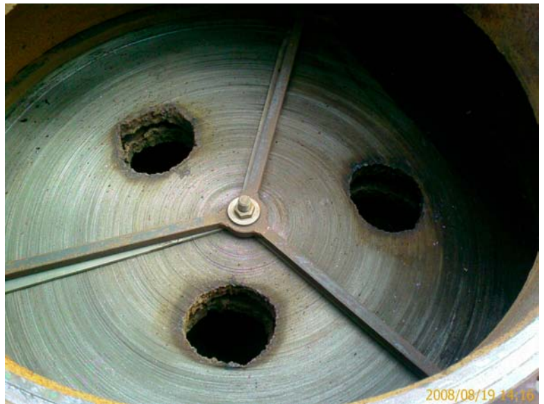
Bild 3: Mit Schweißbrenner eingebrachte Löcher in einer Flammensicherung: Druckverlust behoben – Funktion außer Kraft gesetzt
